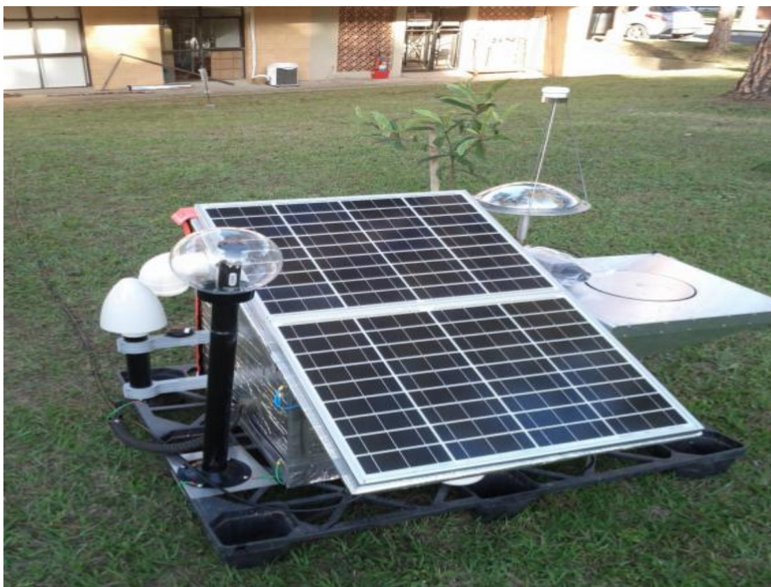
Figura 3 – Equipamentos instalados no Pico do Jaraguá
